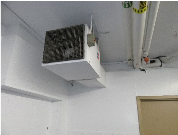
104 – Garbage room exhaust fan
